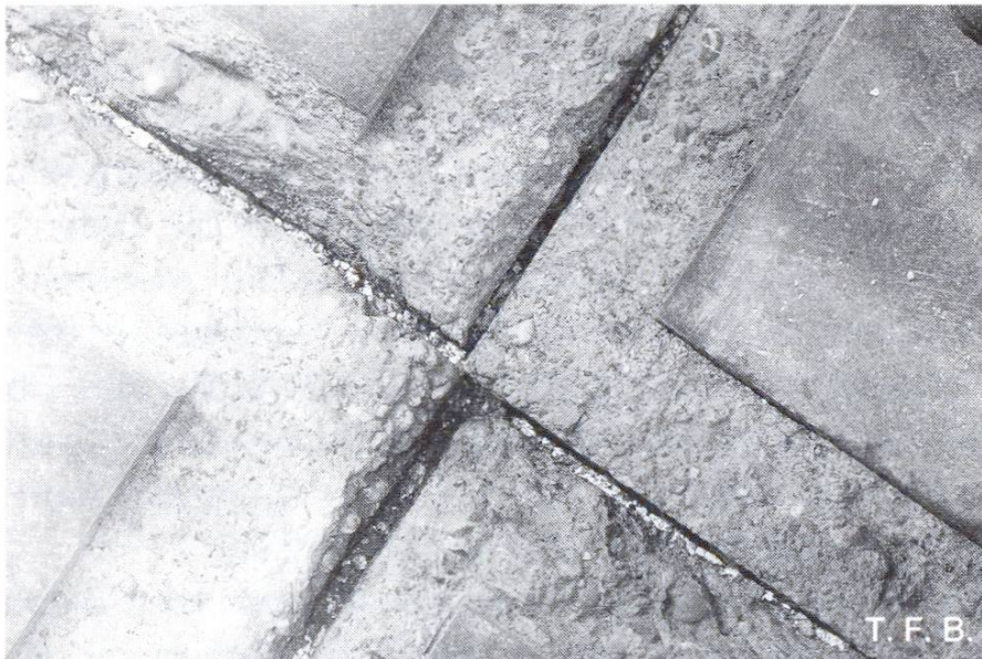
Abb. 7 Die häufig anzutreffenden Fugeneinlagen aus 10mm Schaumstoff und mehr sind hier ungeeignet. Zudem waren die Fugen nicht geradlinig durchgeführt. Im Bereich der Kanten platzte der Hartbeton ab und musste erneuert werden. Also: sauber abschalen, Fugenstreifen von weniger als 6mm Dicke verwenden.
