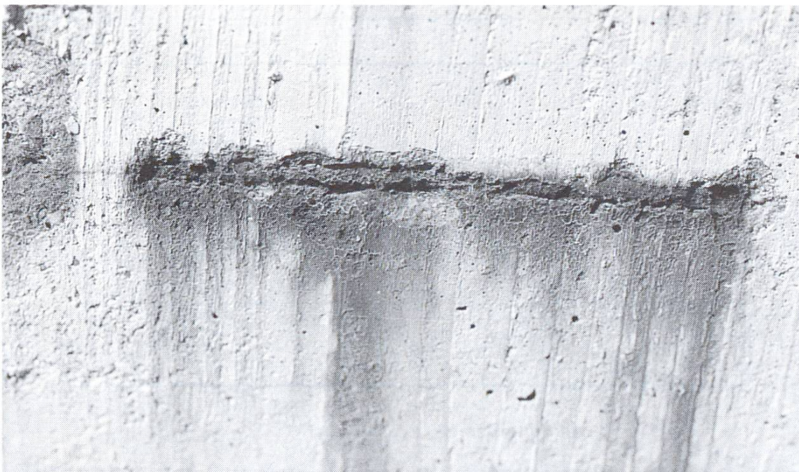
Abplatzungen als Folge von Bewehrungskorrosion.
