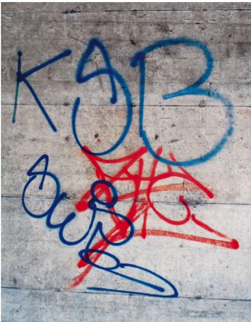
Eine besondere Art von «Betonverschmutzung»: Graffiti.
