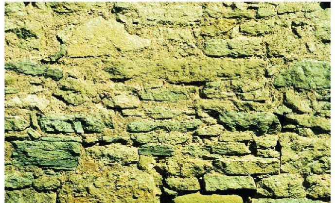
Hinter dem abfallenden Putz kommt das alte Mauerwerk zum Vorschein: Hausmauer in Lenzburg.
