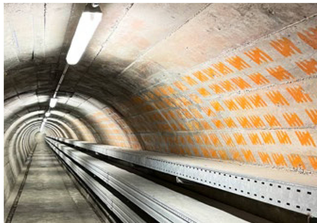
20 000 Striche an der endlosen Tunnelwand illustrieren, für wie viele Menschen die Anlage geplant wurde. Foto Stéphane Herzog
