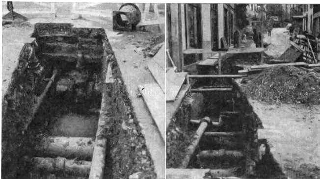
Fig. 1. Wie es unter der Strasse aussieht. Fremde Werkleitungen als Hindernisse Ce que l'on découvre sous la chaussée. Obstacles formés par des conduites étrangères
