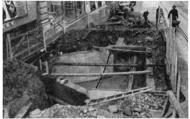
Fig. 4. Grosse Dreieckschacht vor einer Zentrale. Einmündung von 500 mm und 300 mm \varnothing Betonröhren Grande chambre triangulaire devant un central. Aboutissement de tuyaux en béton de 500 et 300 mm \varnothing
