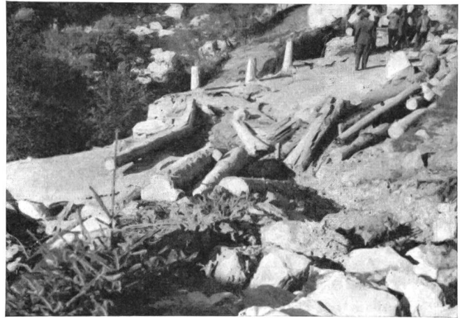
Fig. 6. Strassenzustand nach der Sprengung Etat de la route après l'explosion
