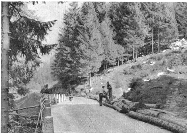
Fig. 2. Sicherung des Kabels durch ein Rundholzpolster Protection du câble au moyen de rondins.
