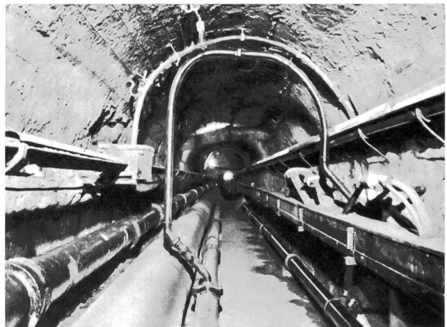
Fig. 10. Werkleitungen in einem Stollen
