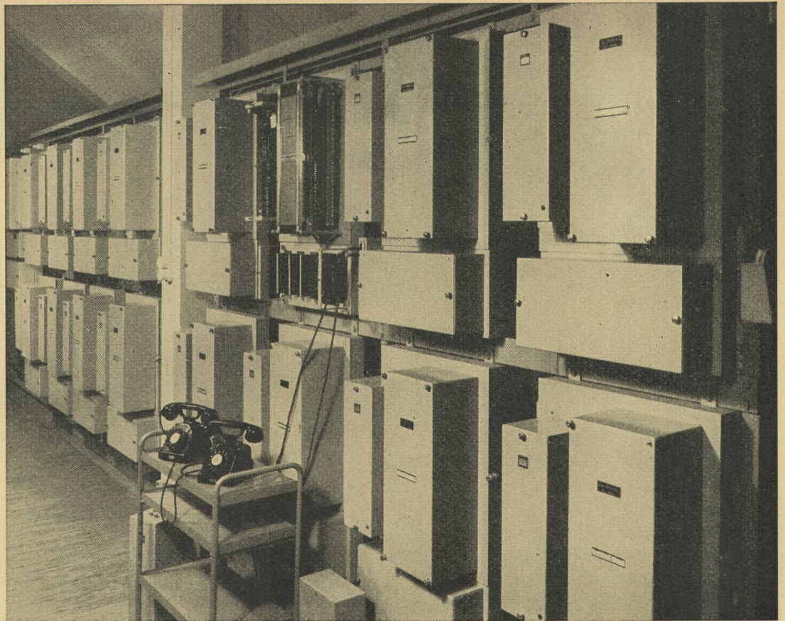
Gestellreihe mit Leitungsdurchschaltern
