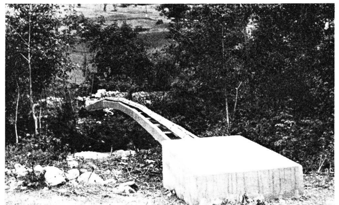
Fig. 1. Kabelbrücke mit Profilträgern; Spannweite 18 m Canalisation supportée par un ouvrage en fers profilés; portée 18 m
