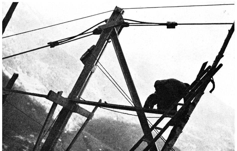
Fig. 8. Abspannklemmen an einem Zwischenmast eingesetzt. Das Kabel zwischen den Abspannklemmen ist zuglos Brides d'attache montées sur un mât intermédiaire. Le câble n'est soumis à aucun effort de traction entre les brides
