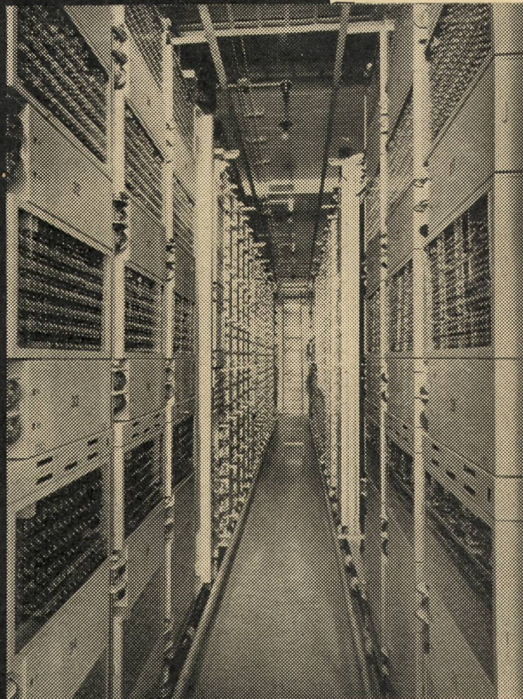
▲ Quartierzentrale Morgartenring Typ-7Az, Ansicht des Wählersaales.
