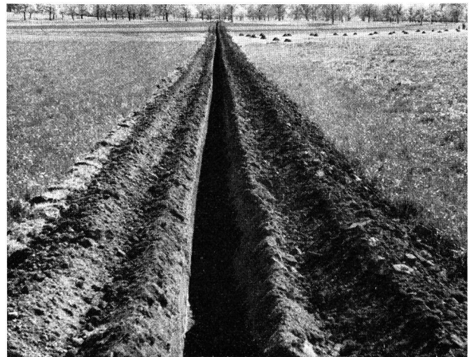
Fig. 10. Beispiel eines mit Kettenbagger ausgehobenen Grabens. Das Material ist getrennt gelagert Exemple d'une fouille creusée au moyen d'un excavateur à chaîne sans fin à godets. Le matériel est déposé séparément de chaque côté de la fouille
