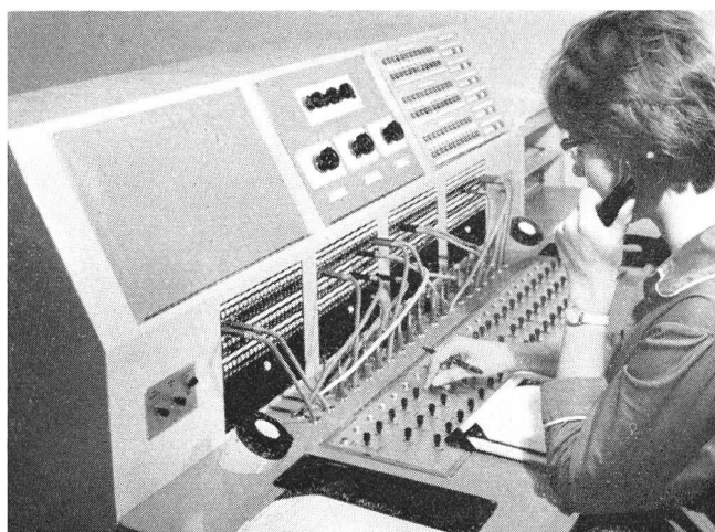
Fig. 6. Dienstpult mit Klinkenfeld, HF- und NF-TR-Überwachung und dem Alarmlampenfeld
