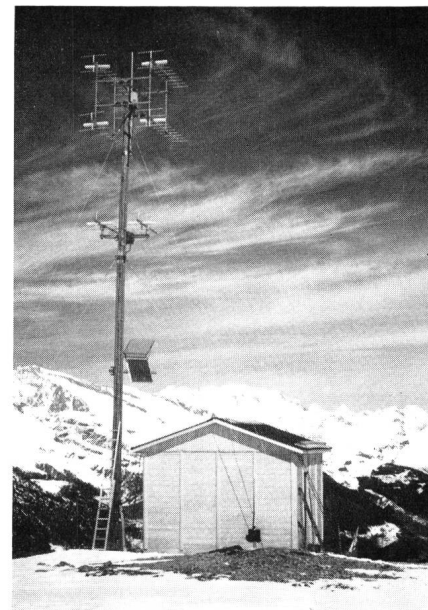
Transistorisierter Fernseh-Umsetzer Gebidem (Wallis) mit Energieversorgung durch Solarzellen
