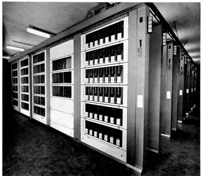
Fig. 10 Erste Pentaconta-Zentrale der Schweiz in Regensdorf. 6000 Anschlüsse, ausbaubar auf 10 000. Eingeschaltet am 28. September 1966 Premier central Pentaconta établi en Suisse, à Regensdorf. 6000 raccords, extension possible à 10 000. Mis en service le 28 septembre 1966
