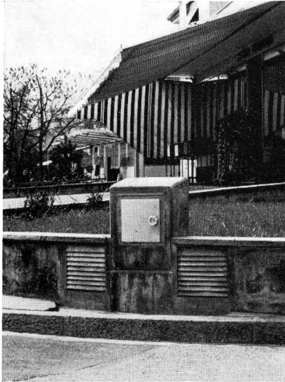
Fig. 25 Messstelle in vorfabriziertem Kamin, Lüftung in Mauernischen
