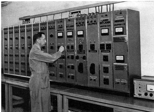
Fig. 1 Installation d'essai pour étudier l'exploitation des accumulateurs sous tension constante
