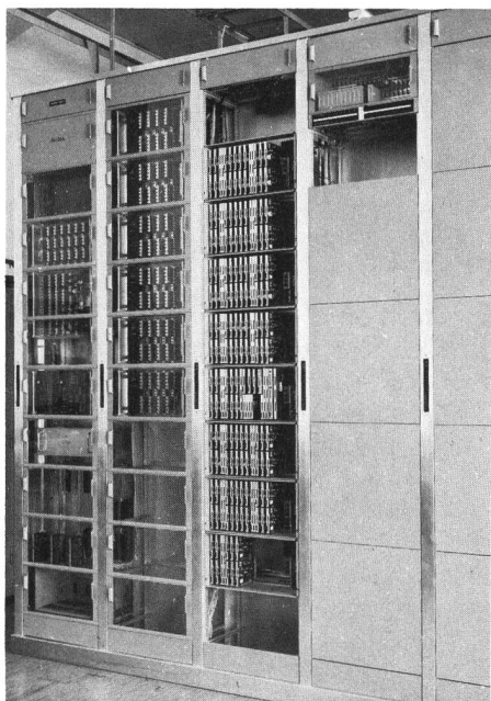
Fig. 17 Unterzentrale für 140 Teilnehmeranschlüsse (drittes Gestell von links) – Sous-central pour 140 raccordements d'abonnés (troisième bâti depuis la gauche)
