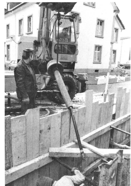
Fig. 5 Einführen des Rammapparates in die Arbeitsgrube. Der Konus an der Spitze des Apparates dient dem Ausweiten der Stahlrohre und gewährleistet die einwandfreie Kraftübertragung und Rammgenauigkeit
