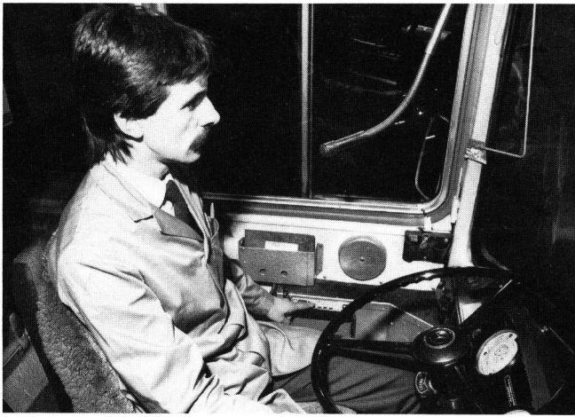
Fig. 10 Einbau der Sprechfunkanlage im Postauto
