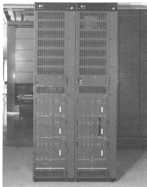
Fig. 3 Equipements DOCAT dans un central de quartier – DOCAT-Ausrüstungen in einer Quartierzentrale
