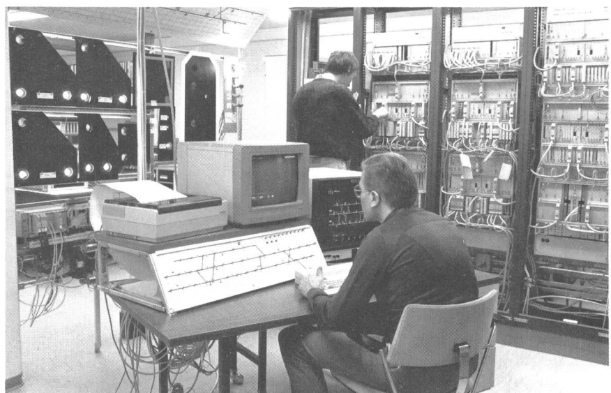
Fig. 1 Voll-elektronisches Stellwerk auf dem Prüfplatz im Laboratorium des Technischen Büros Siemens-Albis in Bern
