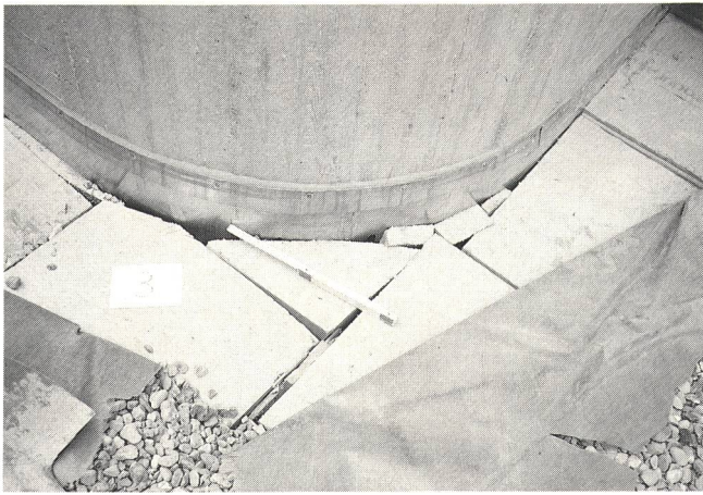
Fig. 10 Schlecht verlegte obere Isolationsplatten beeinträchtigen die Funktionstüchtigkeit des Daches
