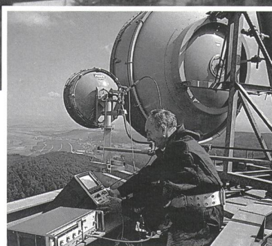
Inbetriebnahme einer Richtfunkverbindung
