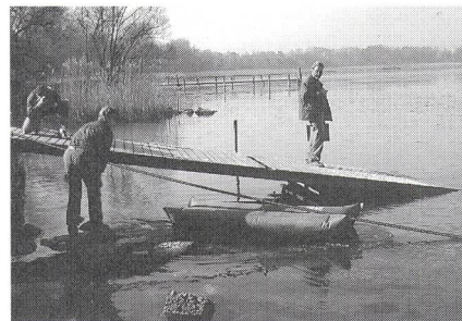
Fig. 5 Kabeleinlauf in den See
