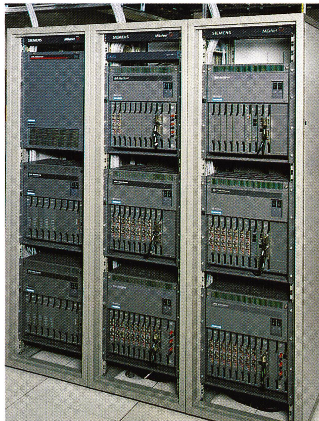
Fig. 3 SIMUX 3645 Cross-Connect numérique, de moyenne taille, utilisé dans l'épine dorsale MilaNet et le niveau interurbain. Extension possible jusqu'à une capacité de commutation de 512 Mbit/s.
