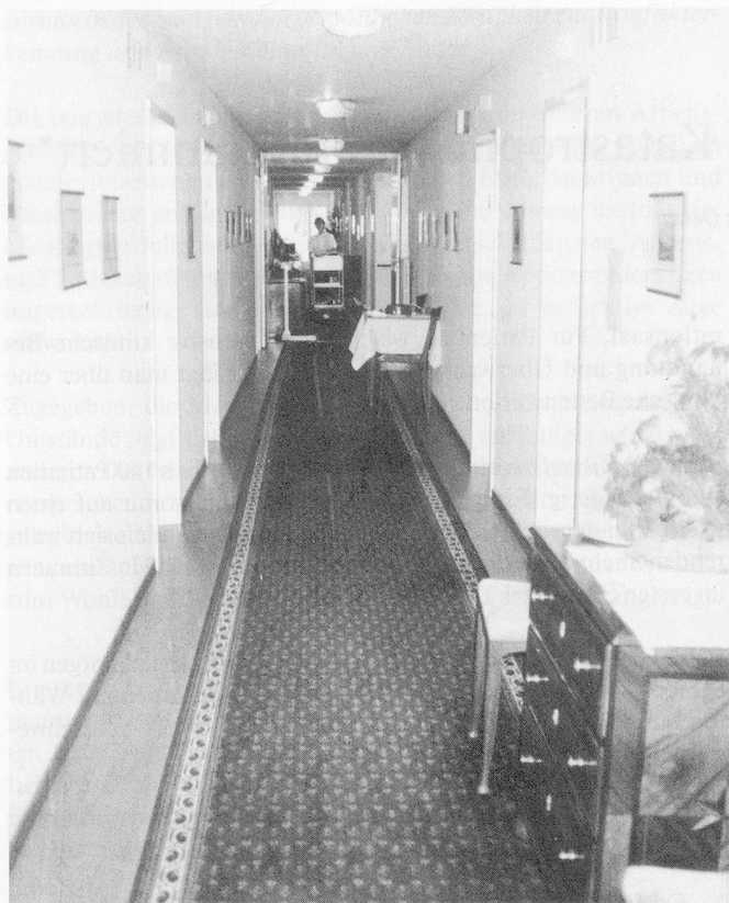
Auf allen Stockwerken gibt es lange und enge Gänge, bei denen Brand- schutztüren gänzlich fehlen.
