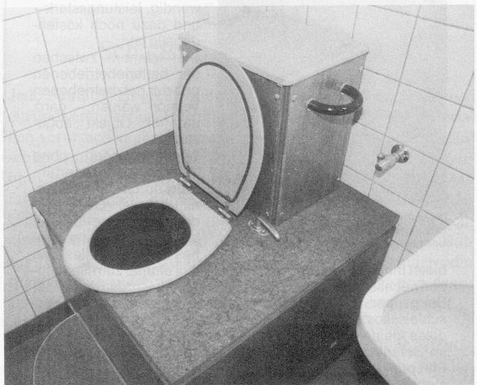
Kompost-WC: am Platz eines normalen WCs steht ein System, welches auf natürliche Weise aus dem Stuhlgang (unter Beizug von Holzspänen) Komposterde «herstellt», und dies ohne Geruchsbelästigung – dank der Lüftung.
