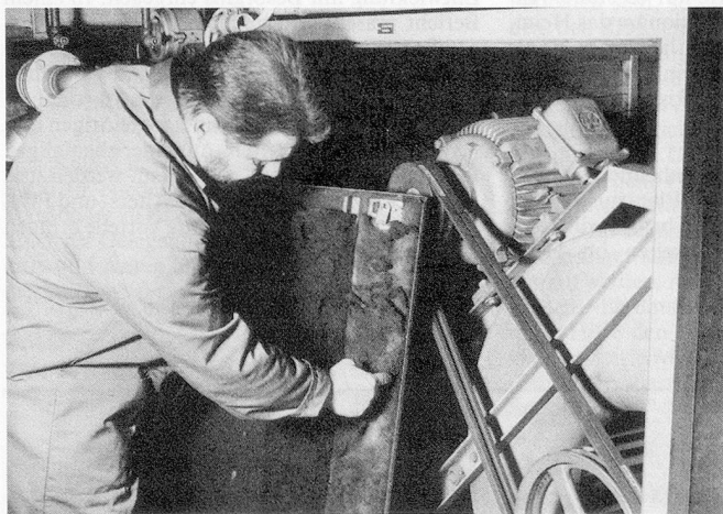
Defekte Monoblock-Isolation belastet die Luftqualität und ist ein idealer Nährboden für Bakterien.
