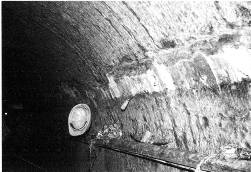
Fig.4. Bentonit von Urdorf-Uetikon im Wasserstollen Hardhof-Strickhof, Stollenmeter 2150. Der Bentonit quillt stark hervor. Photo V. Longo.
