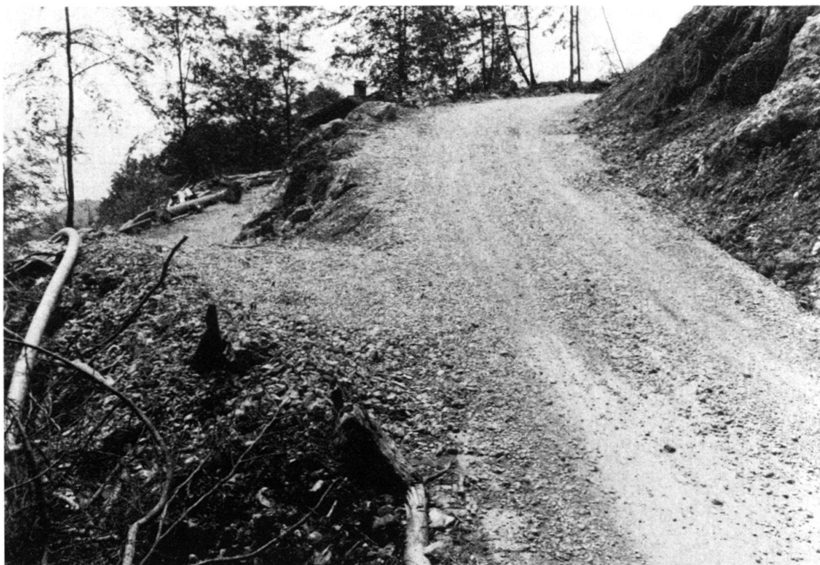
Fig. 11. Begradigung der Strasse beim Haus 1. Links alte, durch Rutschung verschobene Strasse (Aufnahme: 5. Juni 1979). (Bild: Neg. Nr. 9/48/13; 5. Juni 1979.)
