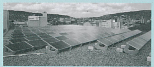
Bei der in der letzten Ausgabe abgebildeten Solaranlage handelt es sich um eine thermische Anlage. Dabei sind die Kollektoren in der sogenannten „Tychemann-Schaltung“ zusammengeschaltet (um in allen Reihen einen gleich grossen Durchfluss zu erreichen). Die Anlage steht auf dem Schulhaus Simach im Thurgau und verfügt über eine Kollektorfläche von 34 m 2 . Im Gegensatz zu einer photovoltaischen Anlage, die direkt elektrische Energie erzeugt, wird die thermische Anlage zur Erzeugung von Niedertemperaturwärme für die Heizung oder das Brauchwasser eingesetzt. In diesem Beispiel ist die Anlage mit einem Erdgas-BHKW gekoppelt.
