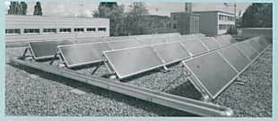
Bei der in der letzten Ausgabe abgebildeten Solaranlage handelt es sich um eine thermische Anlage. Dabei sind die Kollektoren in der sogenannten „Tychemann-Schaltung“ zusammengeschaltet (um in allen Reihen einen gleich grossen Durchfluss zu erreichen). Die Anlage steht auf dem Schulhaus Simach im Thurgau und verfügt über eine Kollektorfläche von 34 m 2 . Im Gegensatz zu einer photovoltaischen Anlage, die direkt elektrische Energie erzeugt, wird die thermische Anlage zur Erzeugung von Niedertemperaturwärme für die Heizung oder das Brauchwasser eingesetzt. In diesem Beispiel ist die Anlage mit einem Erdgas-BHKW gekoppelt.
