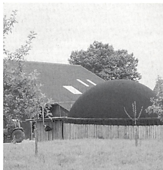
Biogasanlage in Goldach SG
