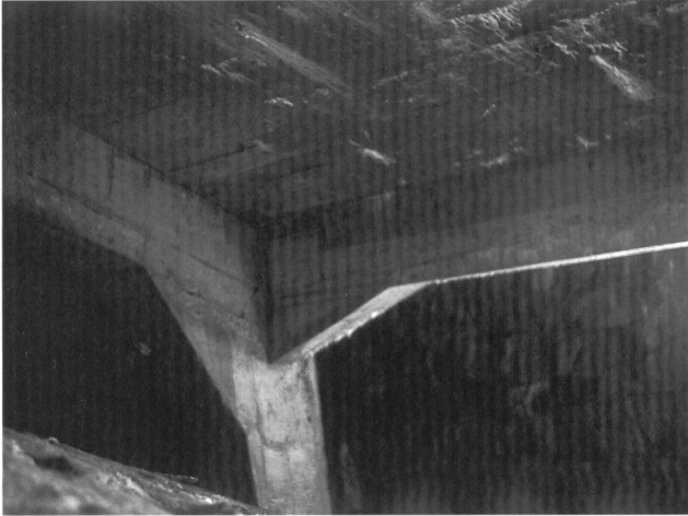
Abb. 11: Stellenweise abgesackte Plattform des Schlageter-Denkmals über dem Gletscherschliff, Aufnahme Fuhrmeister 1996.
