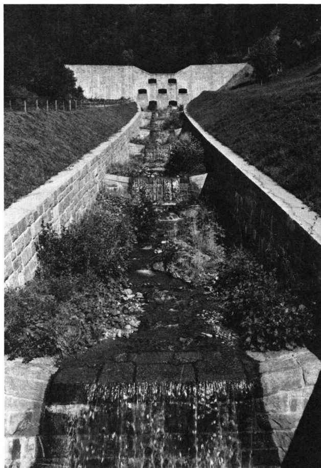
Abb. 12 Grosse Geschiebestausperre am Schluchtausgang des Schrimbaches im Maltatal (Siehe auch Abb. 5). Trotz der grossen Dohlen findet keine selbsttätige Entleerung der Sperre statt. Als weitere Sicherung des untenliegenden Dorfes wurde einige hundert Meter bachabwärts auf dem grossen Schwemmkegel ein Geschiebeablagerungsplatz gebaut.
