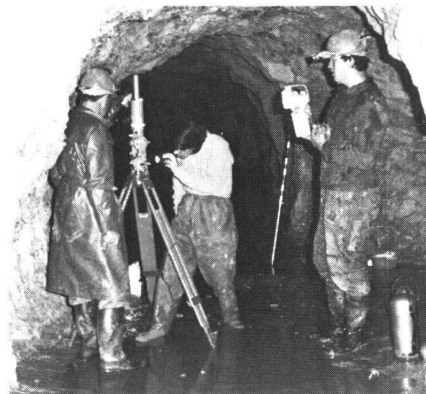
Fig. 7 Mise en station du gyroscope dans les galeries de drainage
