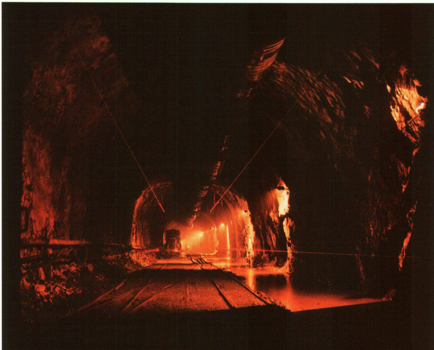
Fig. 1 Lasers de chantier, placés parallèlement, pour la conduite longitudinale des grandes machines de forage.
