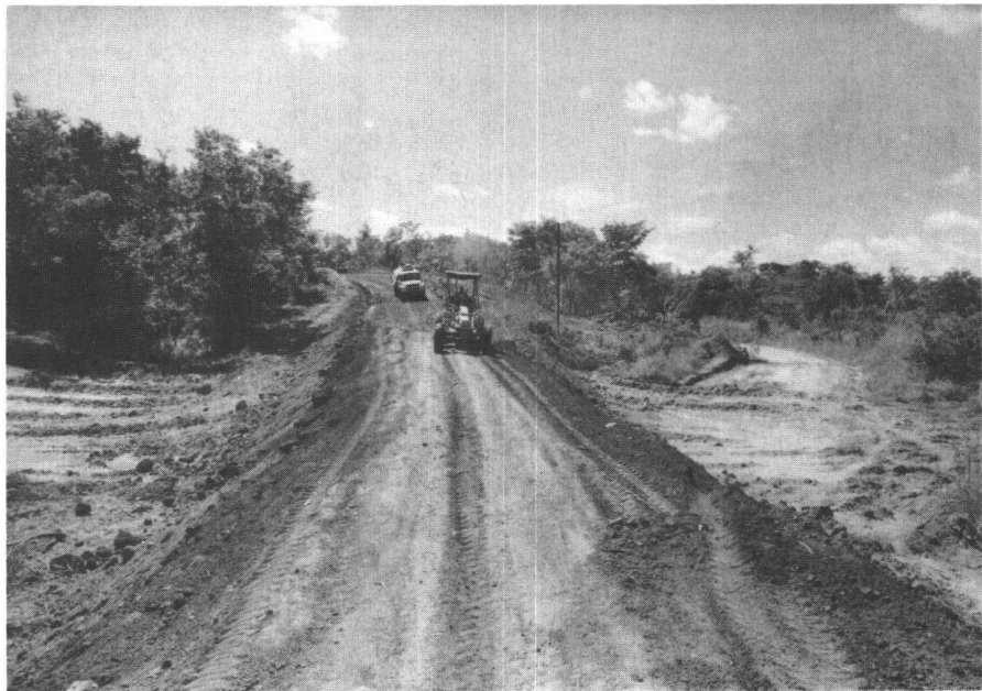
Abb. 4: Oft werden Wasserstellen künstlich geschaffen; z.B. während grösserer Erdarbeiten entstehen Senken oder Verdichtungen, in denen Wasser stehen bleibt. (Foto: IfK, Strassenbau in Tansania).
