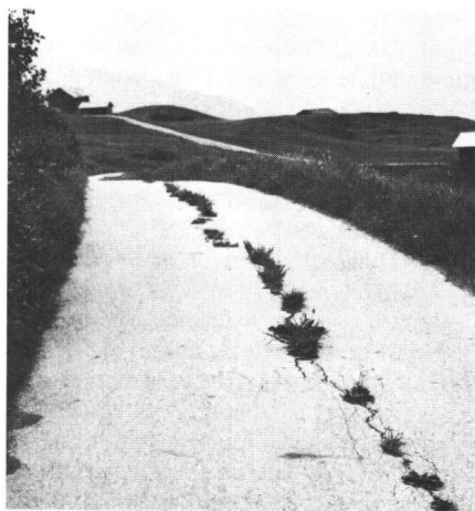
Abb. 2: Solche bereits bewachsenen Längsrisse in der Strassenmitte (Frostschäden) können im Rahmen des laufenden Unterhalts einfach repariert werden, indem die Schadstelle gereinigt, die Risse mit Bitumenemulsion ausgegossen, übersplittet und feststampft werden (Foto: Ch. Boss).
