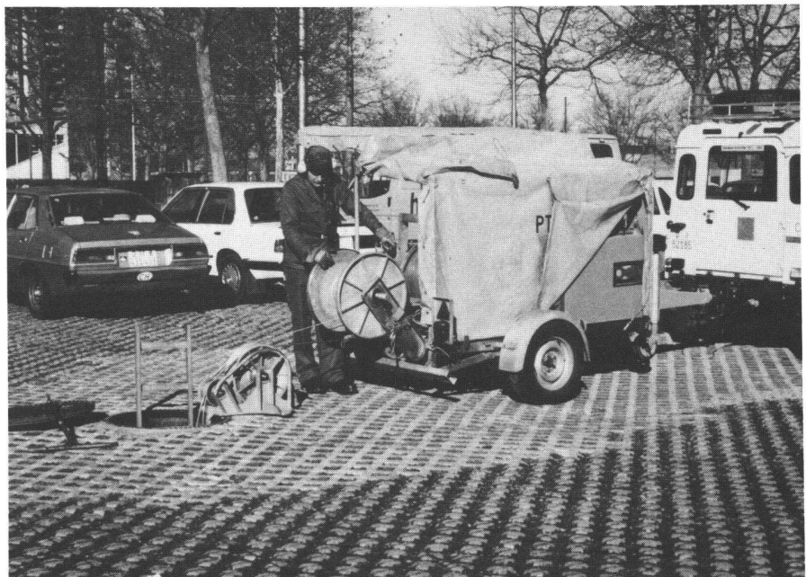
Abb. 8: Kabeleinzug: Vorbereitungsarbeiten für den Einzug eines Glasfaserkabels. Tirage de câble: préparation des travaux pour le tirage d'un câble à fibres optiques.
