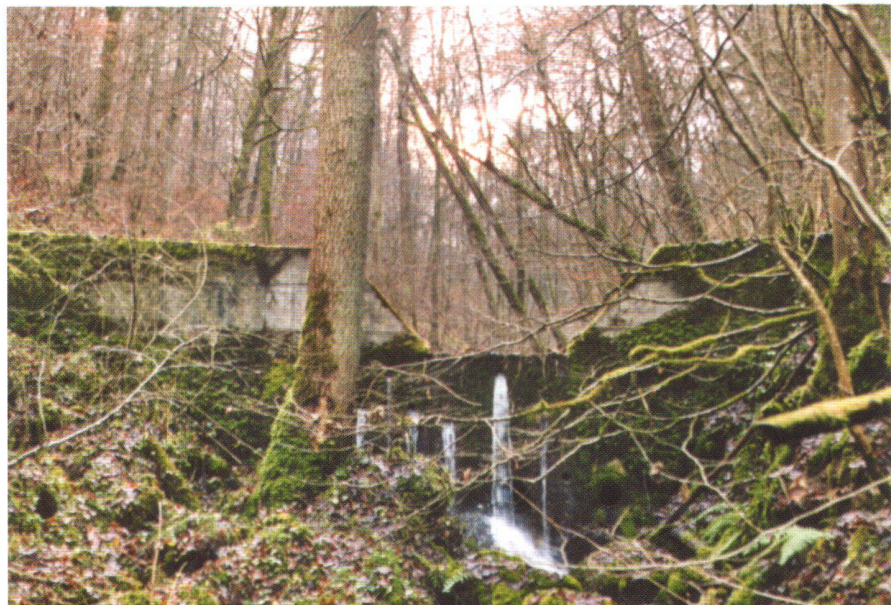
Abb. 1: Massive Betonsperre als Abschlussbauwerk eines Geschiebesammlers am Stutzgraben bei Osterfingen (Kanton Schaffhausen). Solche Geschiebesammler unterbinden jegliche Aufwanderung von Tieren und beeinträchtigen die Bachdynamik entscheidend.
