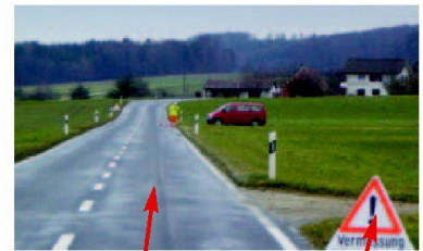
Die Sicherung gegenüber dem Strassenverkehr ist regelkonform.
