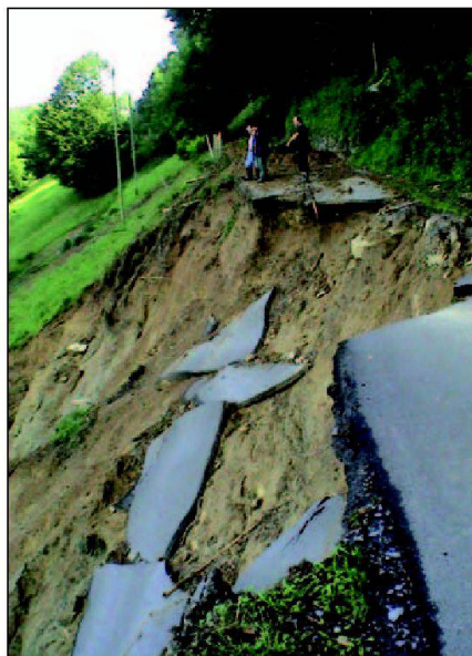
Abb. 3: SZ Arth: zerstörte Hofzufahrt.
