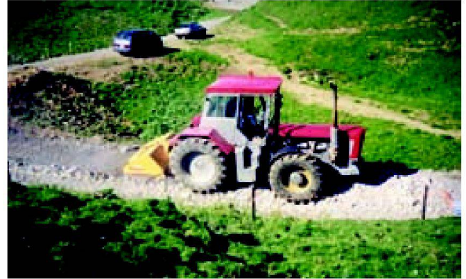
Abb. 7: Die periodische Wiederinstandstellung senkt die Unterhaltskosten (Oberiberg SZ).
