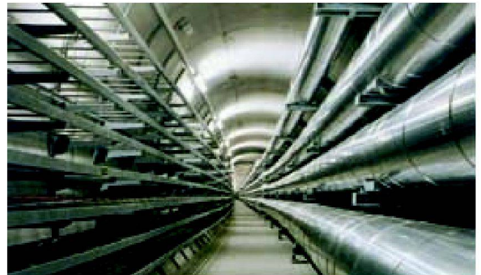
Abb. 1: Energiekanal. © Unique (Flughafen Zürich AG), 2009.
