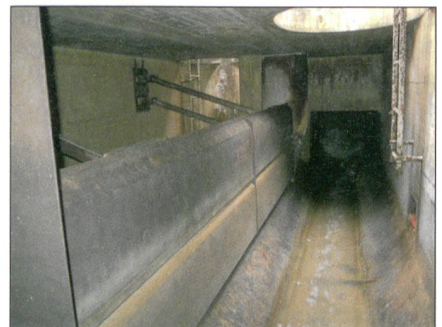
Abb. 2: Hochwasserentlastung in San Nazzaro (Sciarini SA).
