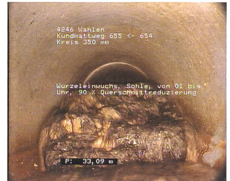
Abb. 1: Bei Kanal-TV festgestellter Wurzelaufwuchs.
