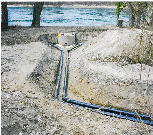
Abb. 15: Bewässerungspumpwerk, Pumpenschacht mit angeschlossenen Druckleitungen.
