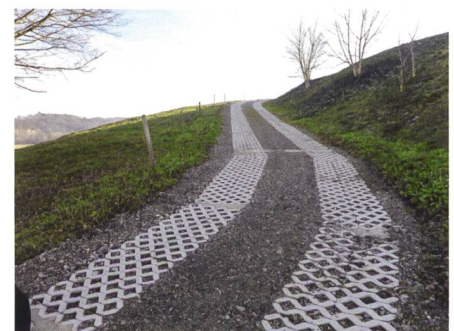
Abb. 10: Ein kurzer steiler Wegabschnitt wurde zur Vermeidung von Erosionsproblemen mit Rasengittersteinen ausgeführt.
