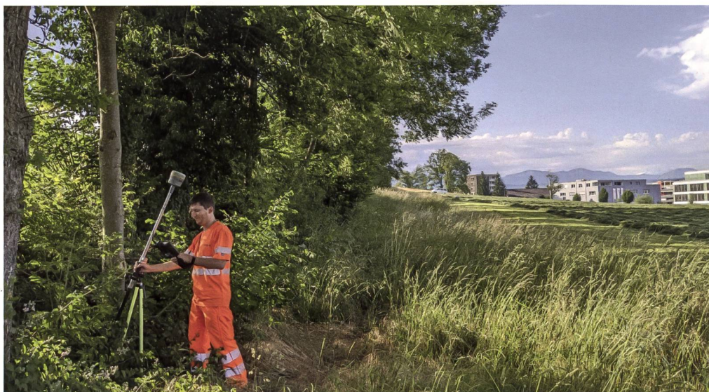
Gute Resultate trotz Abschattung – der Trimble R12i mit Neigungskompensation ermöglicht Pius Mosimann, Projektingenieur bei Kost + Partner AG, ein zügiges Arbeiten (Foto: Kost + Partner AG)
